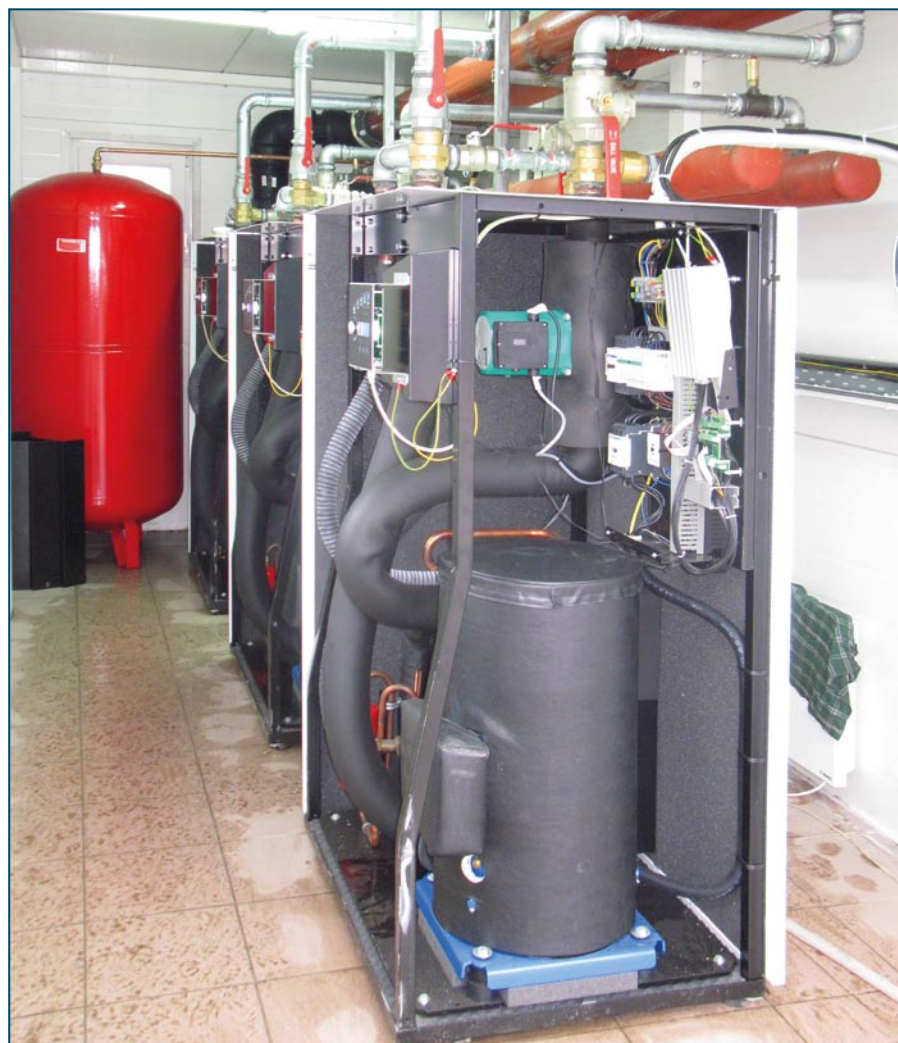
Fot. 3. Instalacja pomp ciepła
