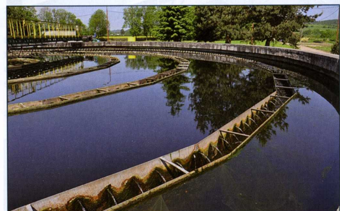
Fot. 14. Osadnik wtórny – wewnątrz z wymiennikiem ciepła
