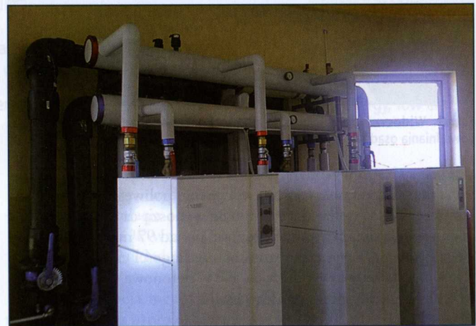
Fot. 13. Pompy ciepła
