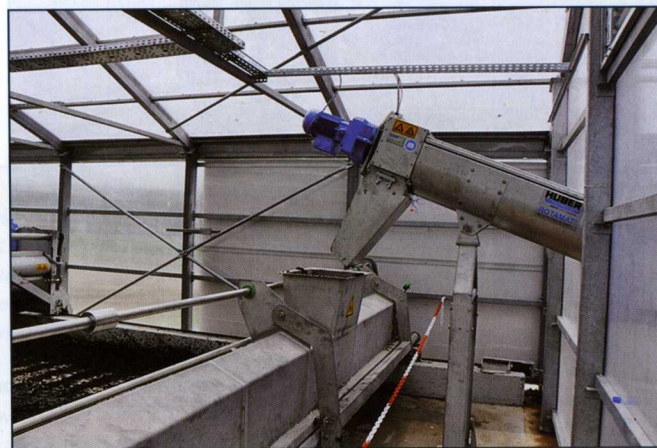
Fot. 7. Układ zadawania osadu do hali
